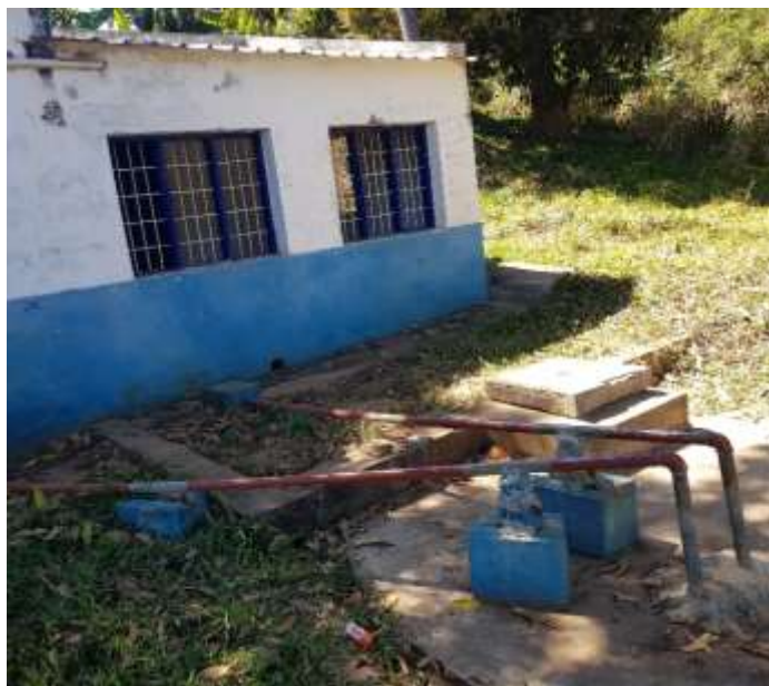
FIGURA 18 POÇO E ESTAÇÃO DE CAPTAÇÃO DO SAA1
